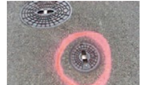
Šupátko je chybné, sú potrebné stavebné opatrenia
