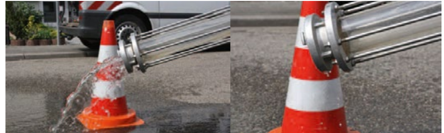
Skúška funkčnosti šupátok výstupom vody z vypúšťacieho hydrantu: Zlé zatvárajúce šupátko - zvýšený výstup vody z priezoru; dostatočne zatvárajúce šupátko - malý výstup vody z priezoru
