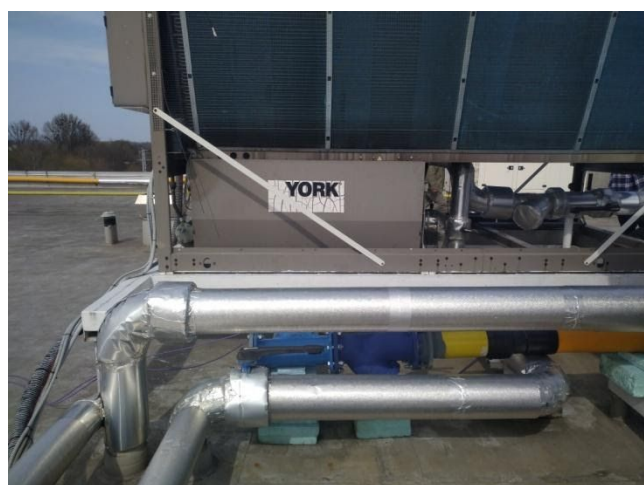
Cistá a efektívne technologické voda
